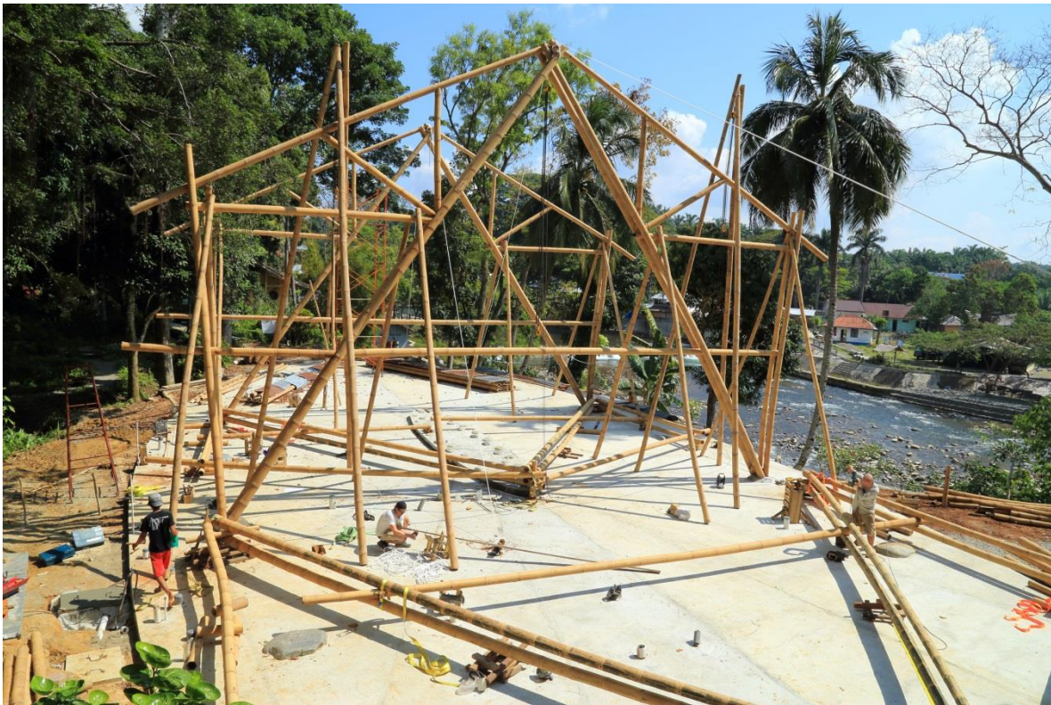
Foto: Estructura en Dendrocalamus asper de 12 metros, Ecolodge Sumatra, Arq. Lukas Zollinger.
