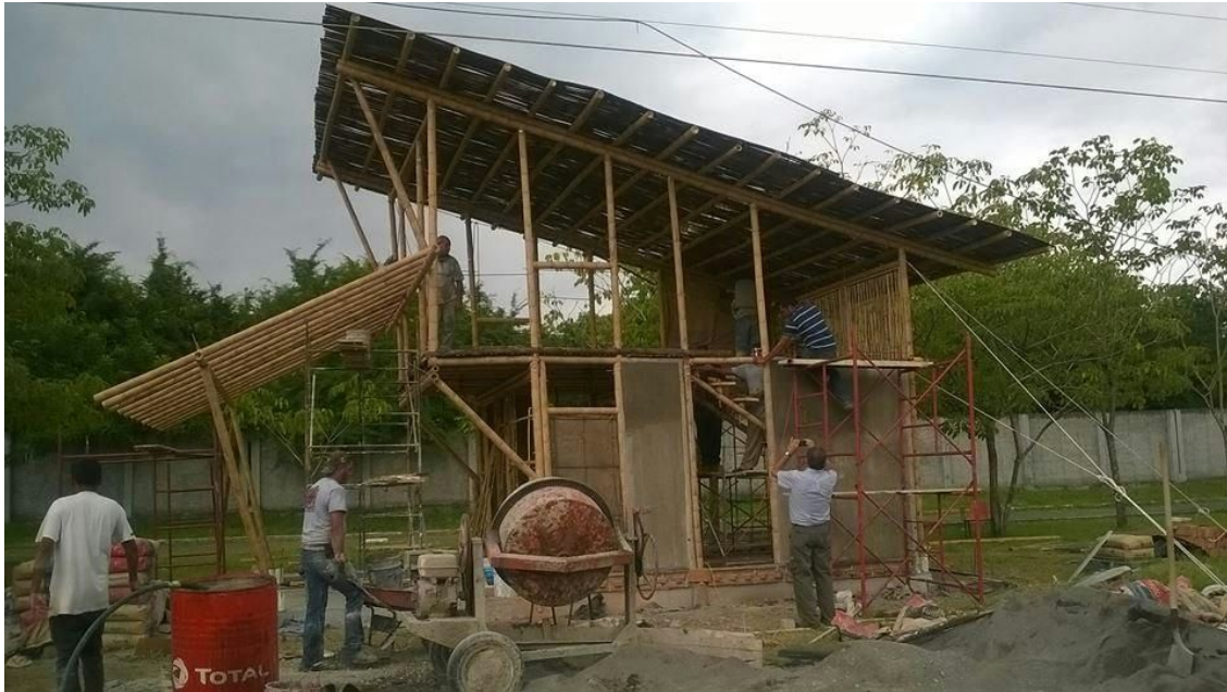
Figura 5. Colocación de esterilla de bambú Oldhami en cubierta y muros tendinosos. Elizondo (2015).
